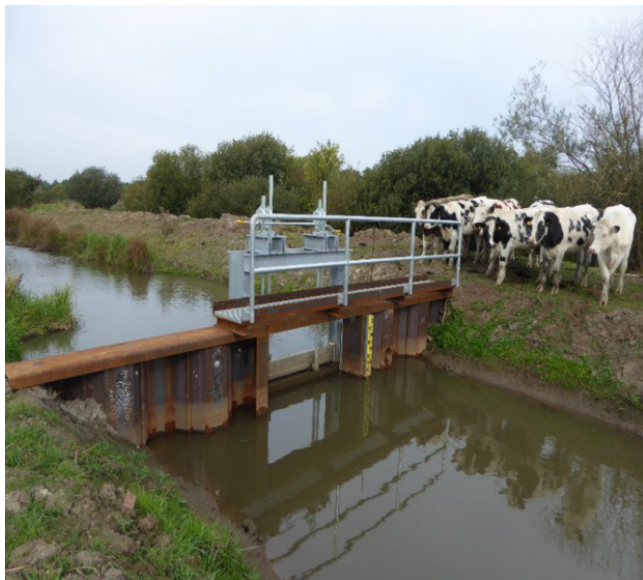
Abb. 4: Das neue Wasserbauwerk reguliert nun die Wasserstände des Polders (Foto: B. Olbrich)
