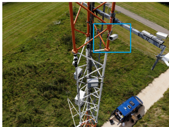
Abb. 162: Obere Wärmebildkamera montiert am NW-Mast in einer Höhe von 20 m
