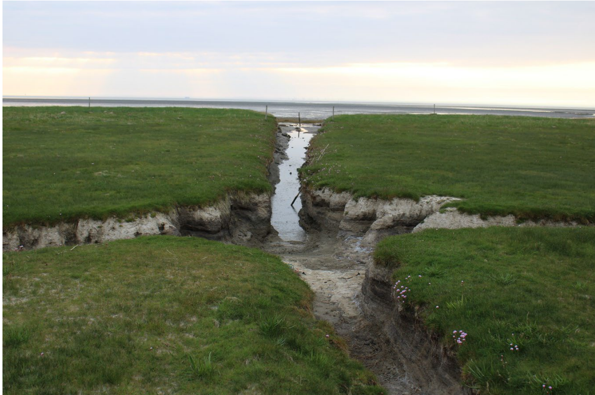
Abb. 19: Ausgespülte Bereiche und Abbruchkanten im Vorland (Bild: Peter Schütte).
