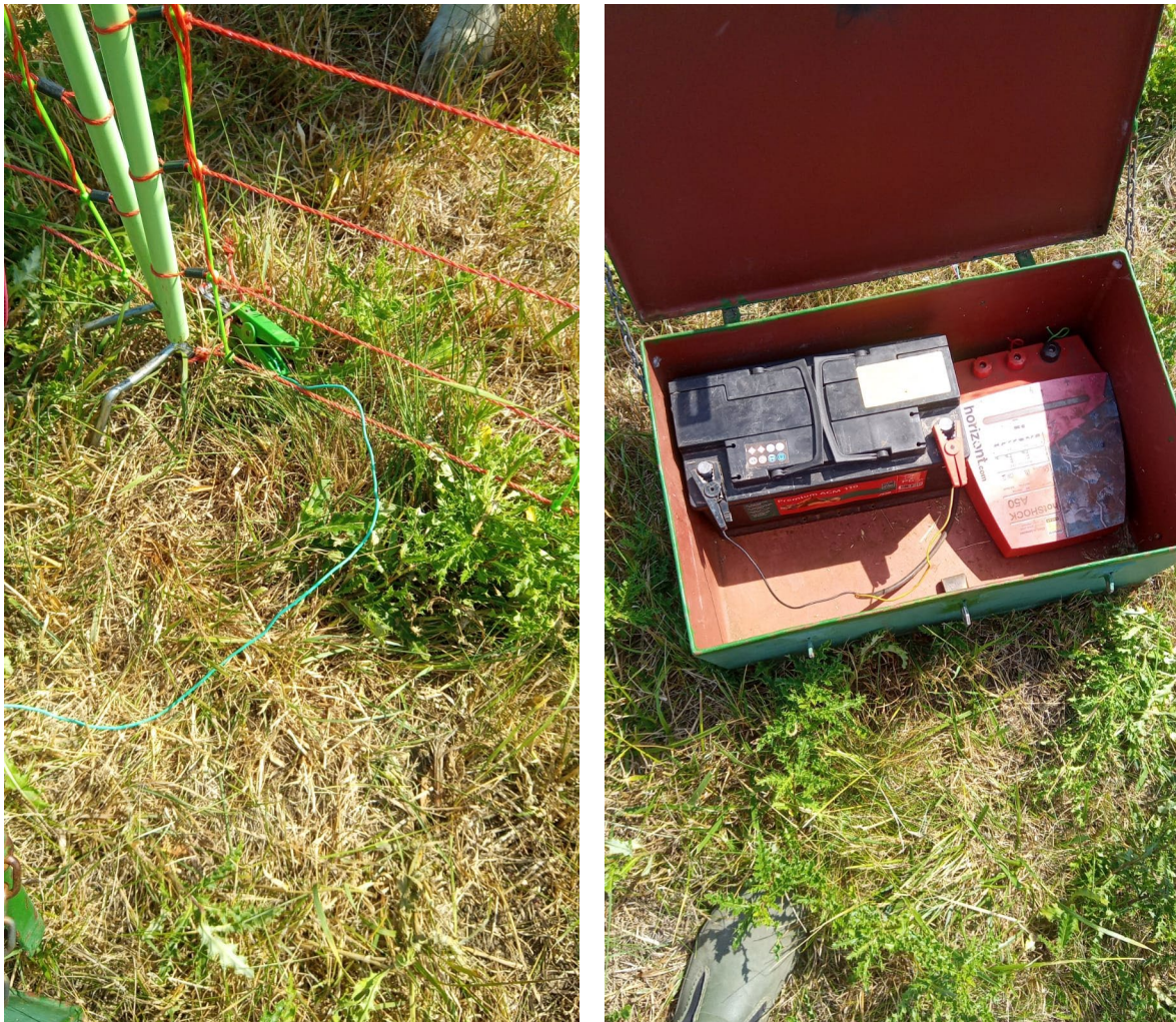
Abb. 96: Die Stromversorgung erfolgt mit Hilfe eines batteriebetriebenen Weidezaungeräts der Firma Horizont (Bild: Swen Keller).
