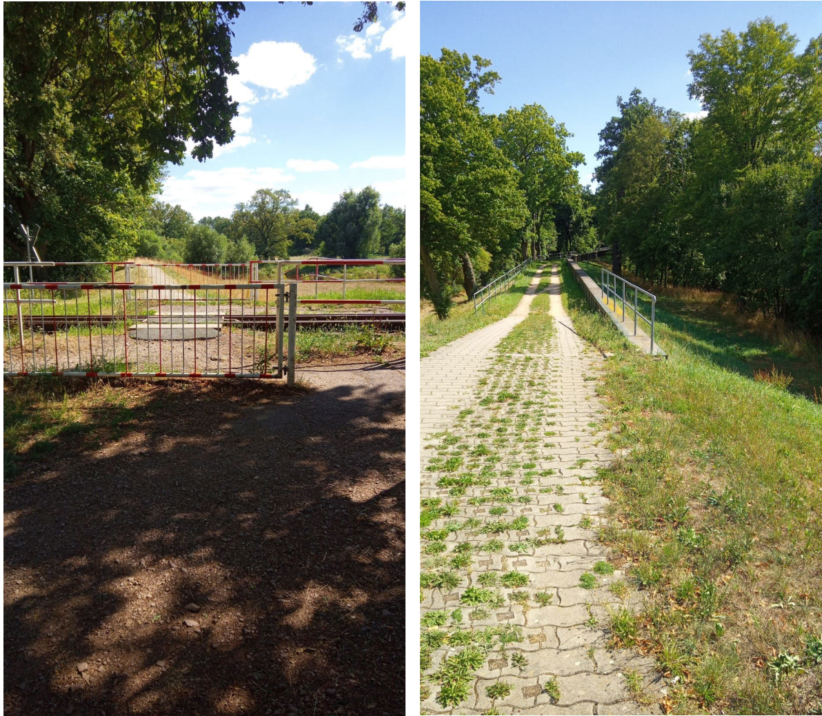
Abb. 75: Übergänge und Überfahrten müssen freigehalten werden (Bilder: Swen Keller).
