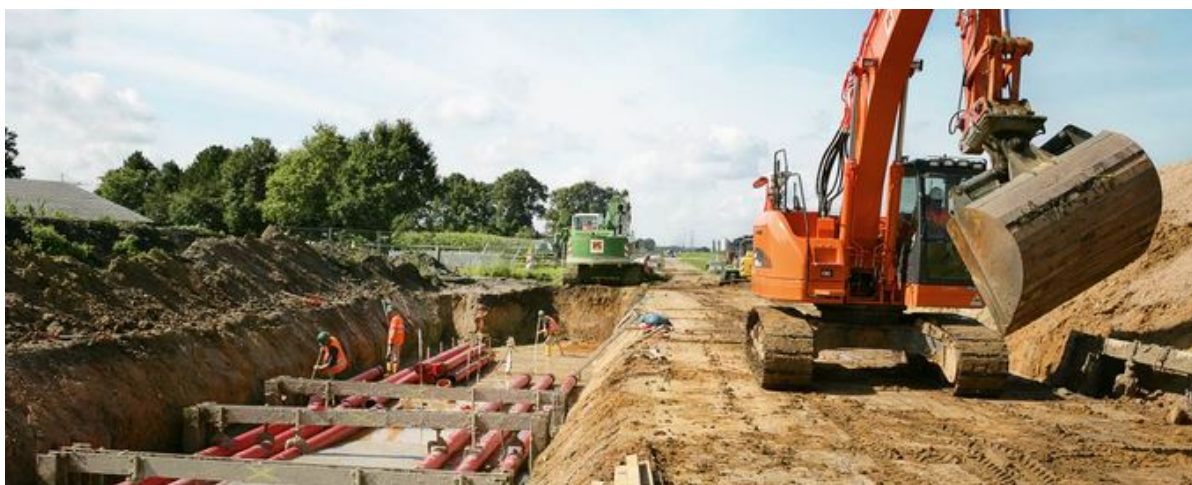
Abbildung 26: Einer von zwei Arbeitsstreifen in Raesfeld, Teilabschnitt Bredenwinkel – Borken-Süd der Leitung Diele – Niederrhein, EnLAG-Vorhaben Nr.5 (Amprion 2019a/Reinhard G. Nießing).
